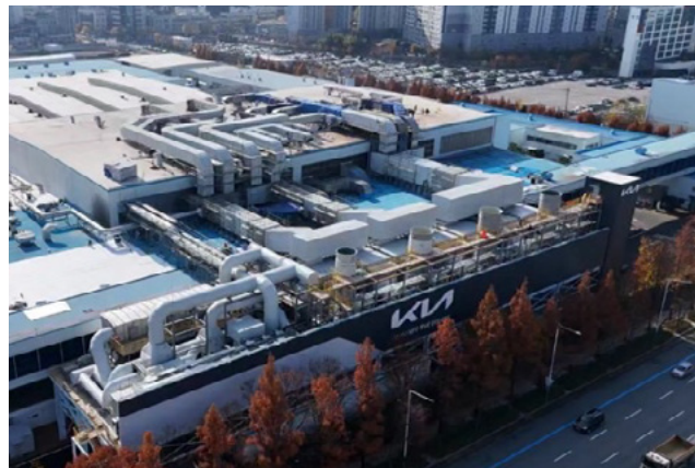
친환경 농축RTO 설치
